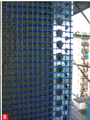
9. Applicazione nuovi doccioni in rame sui parapetti balconi in modo da allontanare l'acqua dalla pavimentazione balconi.
